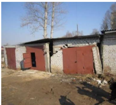
Рис 3. – Результат просадки грунта (сооружение)
