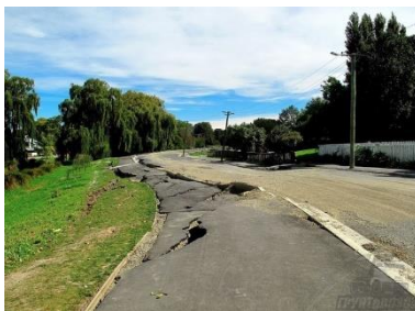
Рис. 2 – Результат просадки грунта (автомобильная дорога)
