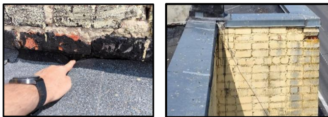
Рис. 1 – Состояние парапета и кровельного карниза
