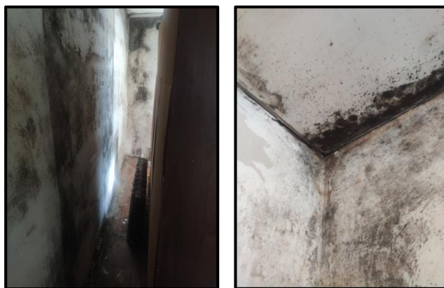
Рис. 1 – Поражение плесенью стен и потолка
