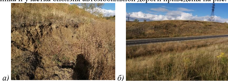
Рис. 2 – Участок оползня в выемке на слабопросадочном суглинке: а – общий вид грунта; б – оползень
