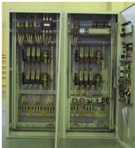
Рис. 2. Шкаф автоматизированной системы управления оборудованием щековой дробилки СМД-118 и пластинчатого питателя [2].
