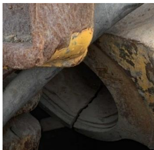
Рис. 1 Разрыва в месте крепления (ухло) балансирной балки
