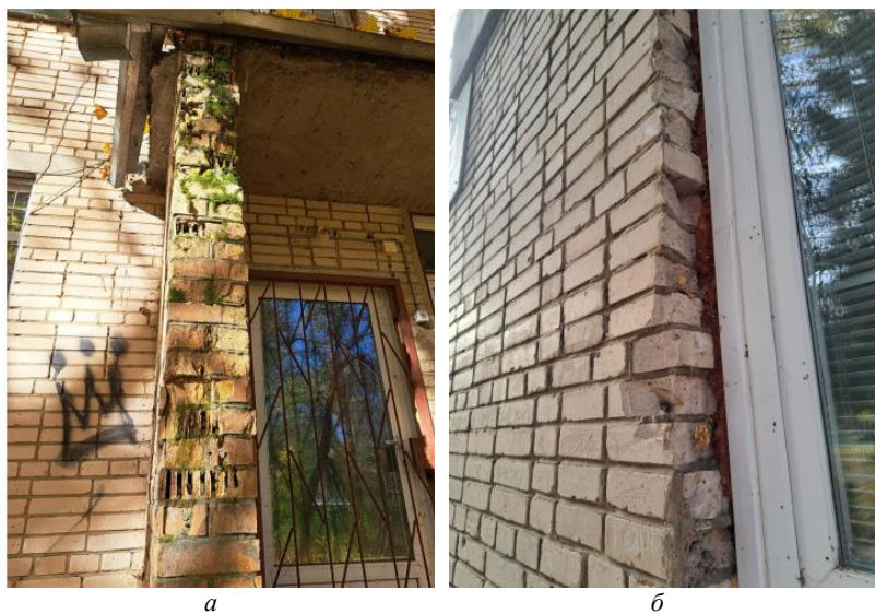
Рис. 2: а – размораживание стены крыльца; б – механические повреждения кирпичной кладки;
