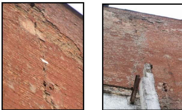
Рис. 1. Повреждение внешней поверхности кирпичной стены
