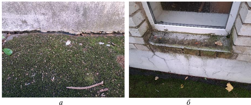
Рис.3: а – зазор между цоколем и отмосткой и отсутствие отлива; б – постоянное намокание и разрушение кирпичной кладки
